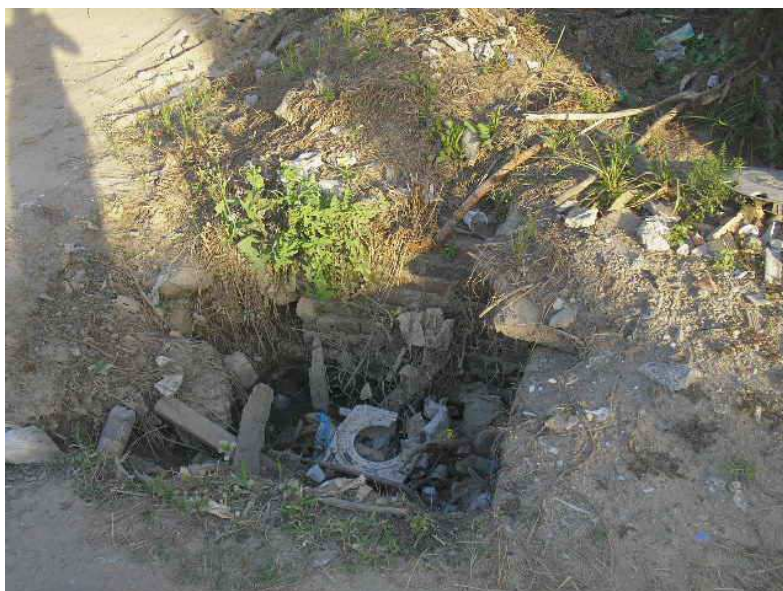
Figura 3 – Situação da tubulação de uma rua do bairro
